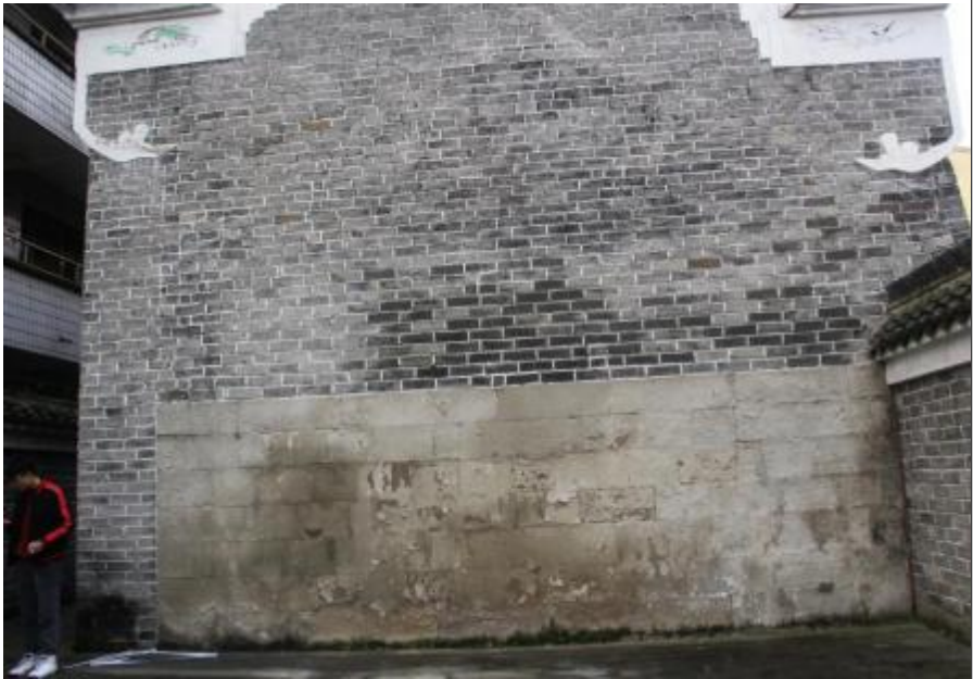
石头基础受潮白浆脱落
