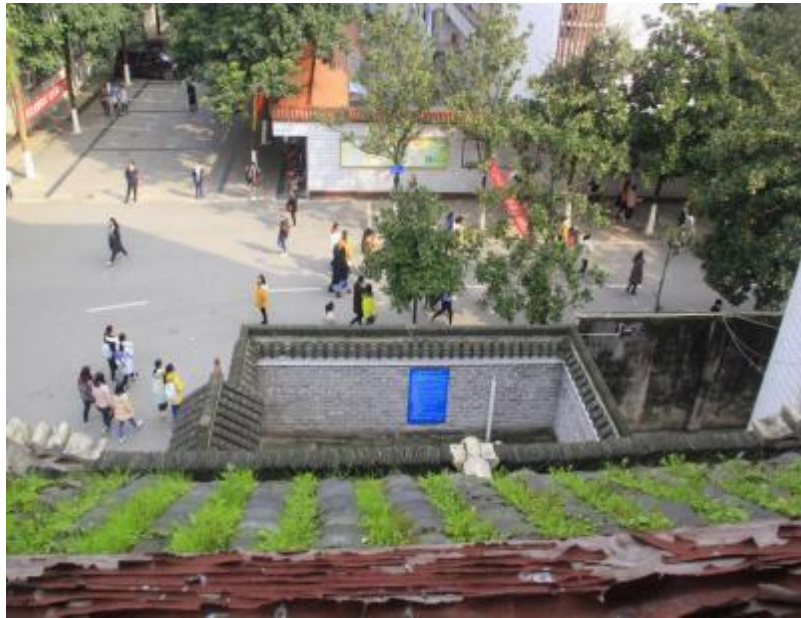
青瓦屋顶雨槽处杂草滋生
