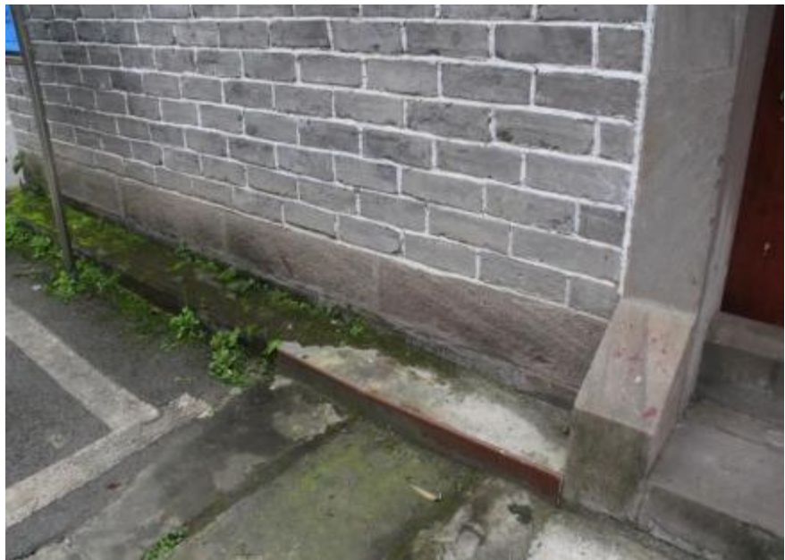
围墙基础处滋生杂草和青苔
