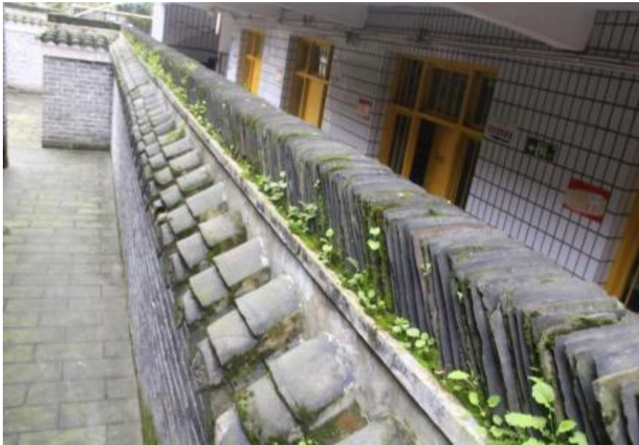
围墙顶青瓦装饰处滋生杂草和青苔
