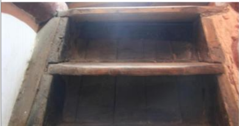
图4-17 二层上 三层木楼梯 (局部潮腐)
