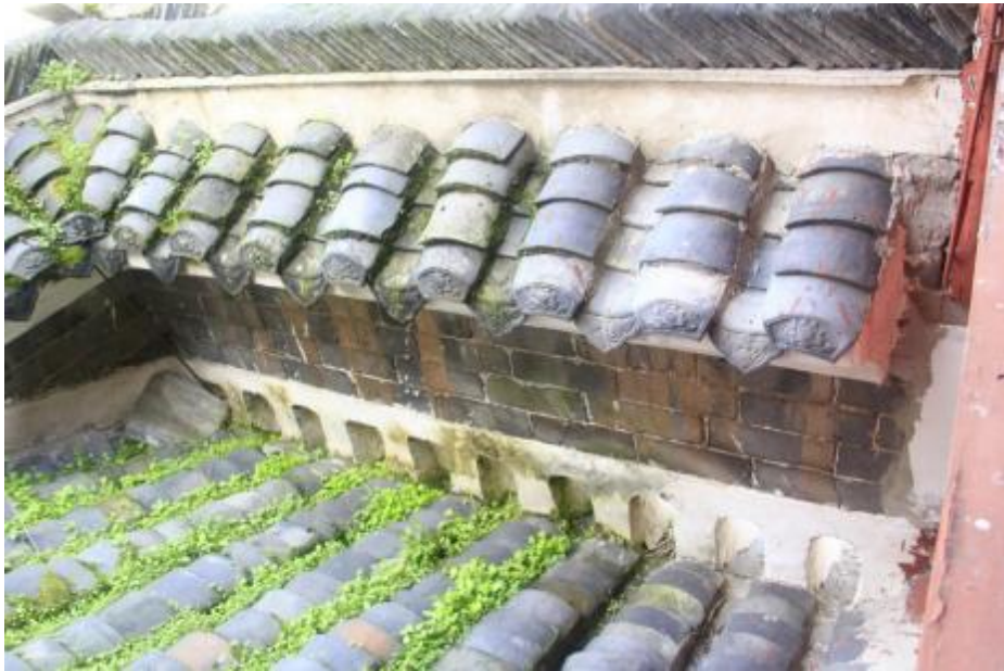
青瓦屋顶雨槽处杂草滋生
