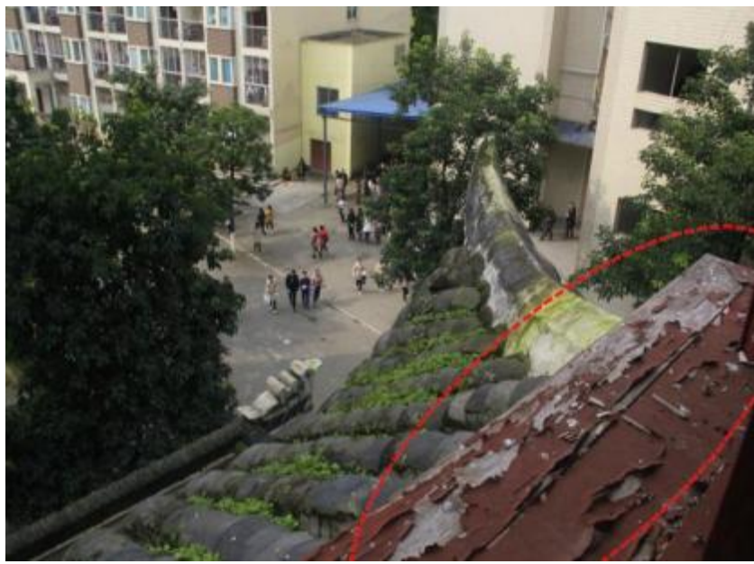
二、三层窗台油漆干裂脱落严重
